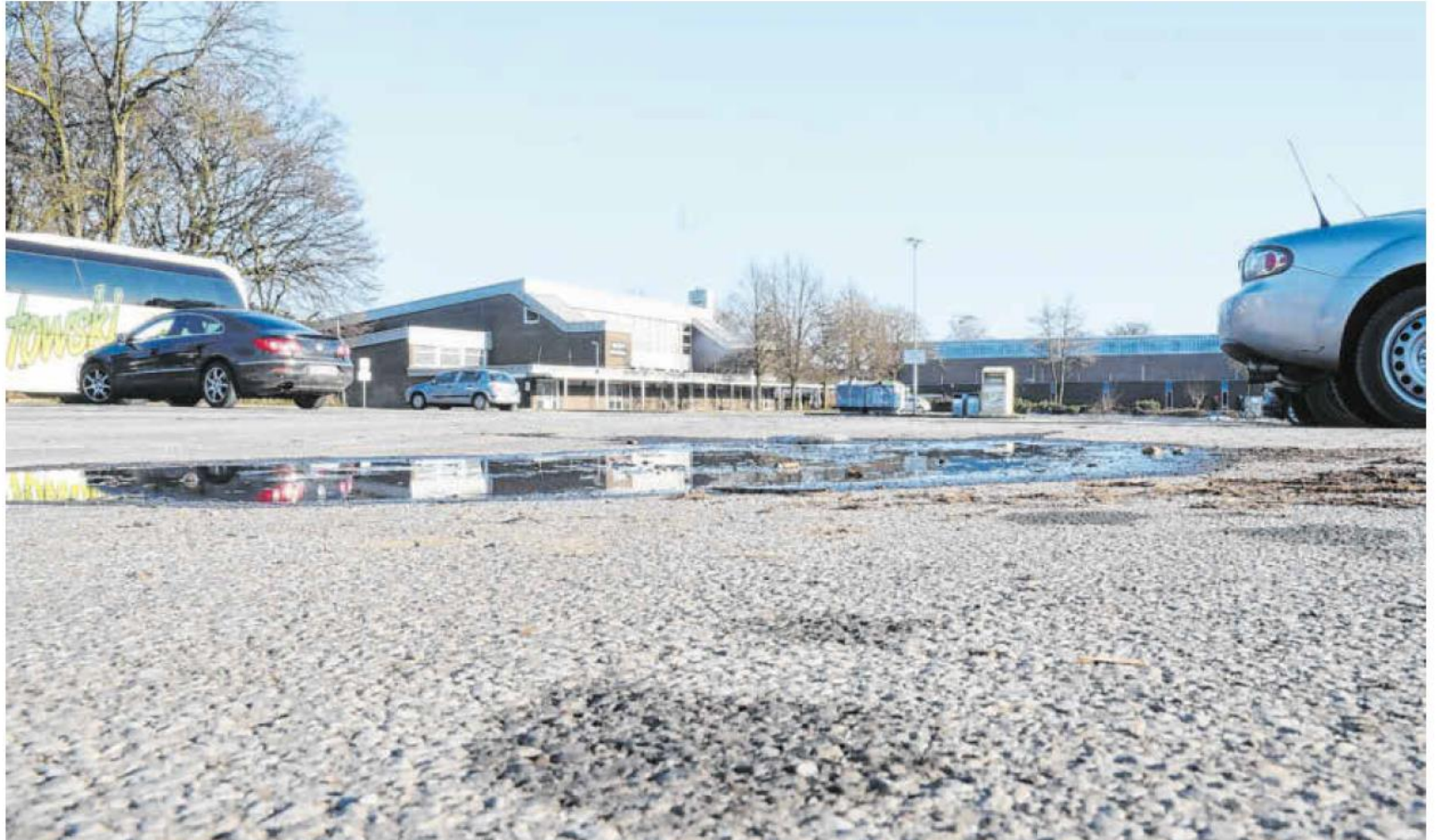
Absenkung: Es arbeitet im Untergrund des ehemaligen Haller Busbahnhofs. Die Pfützen signalisieren Handlungsbedarf.
